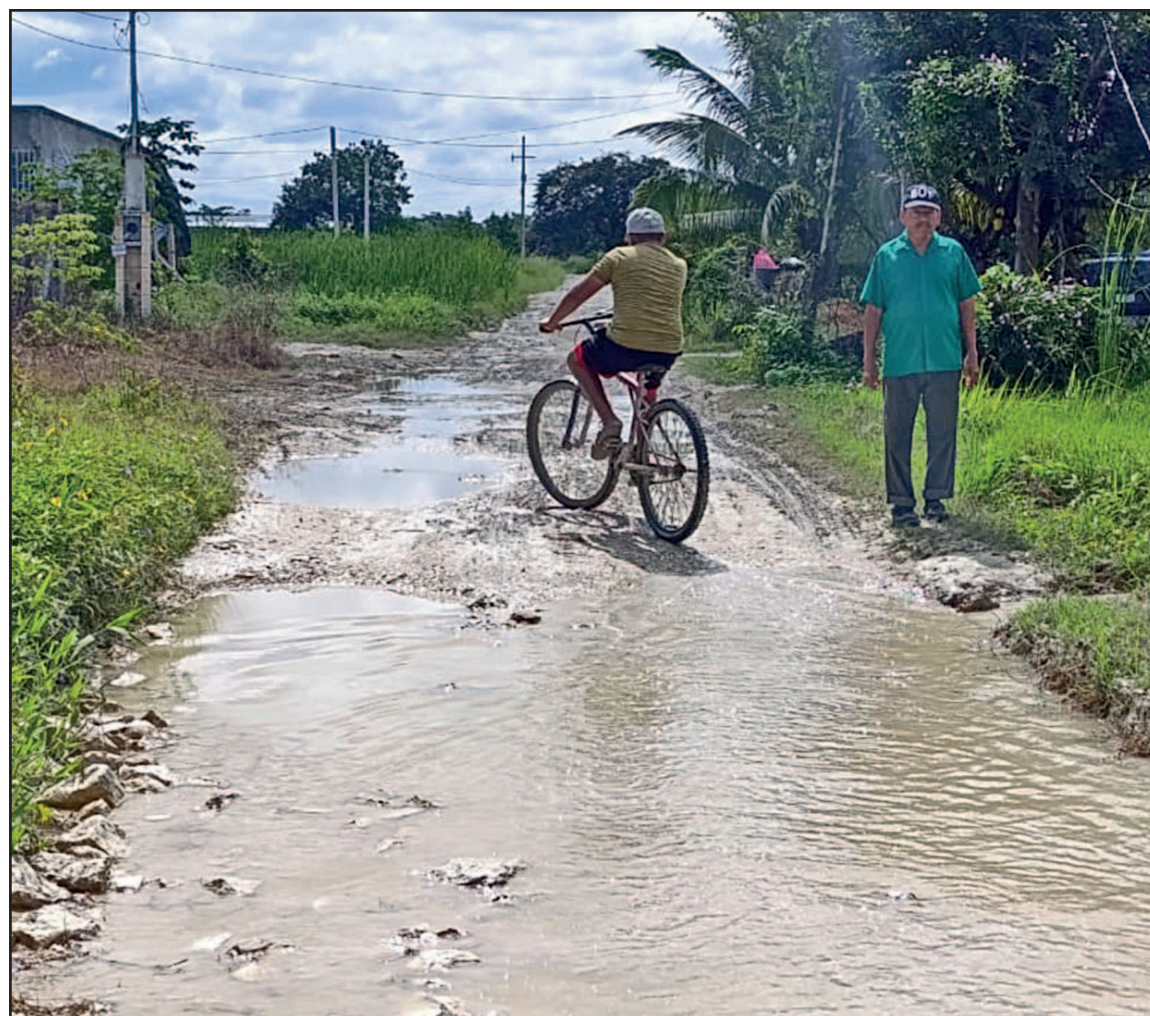
Las condiciones del tramo han empeorado desde que comenzó la temporada de lluvias. (POR ESTO!)
