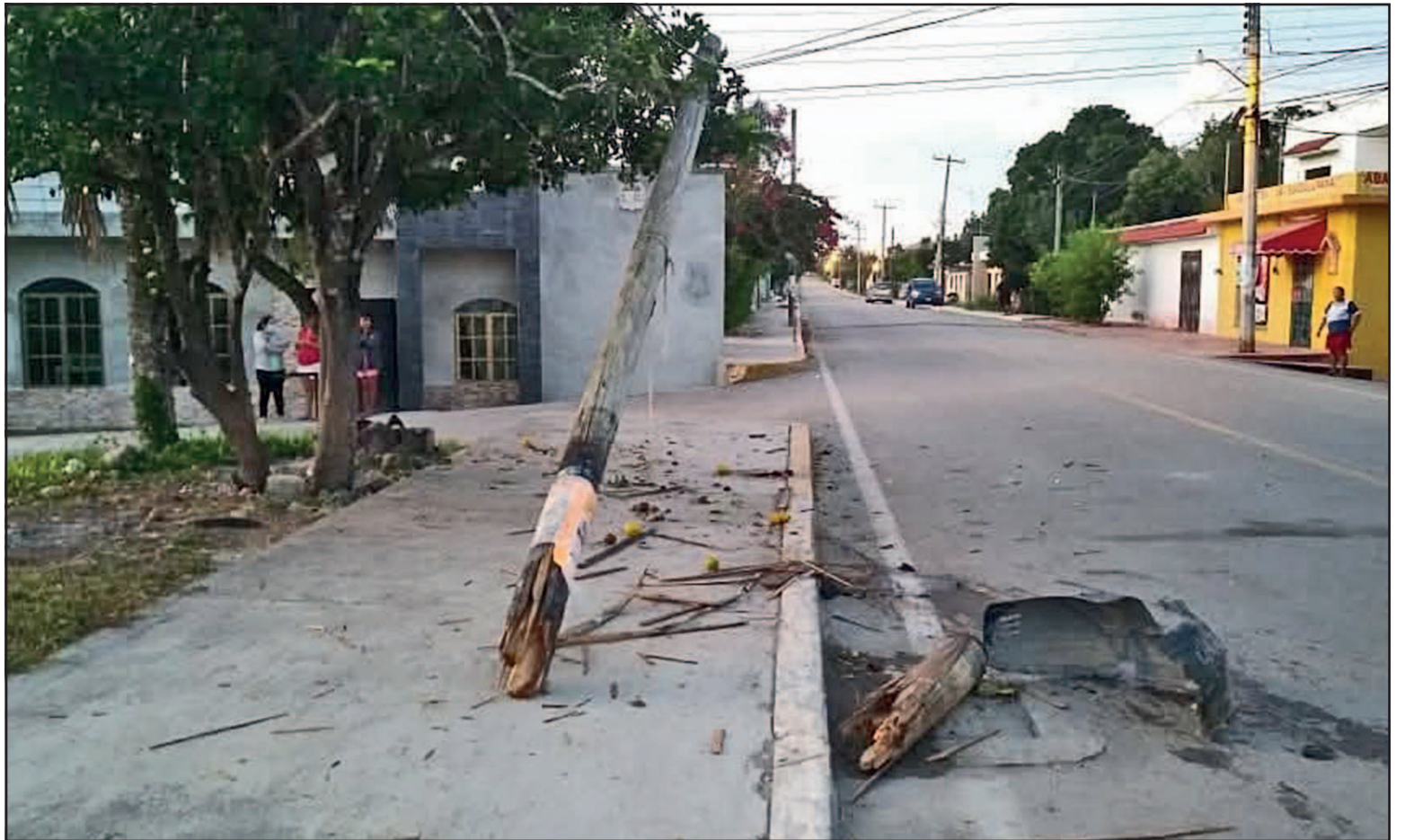
La estructura de madera quedó inservible y colgando de los cables que esta misma sostenía; la autoridad tomó conocimiento del caso.
