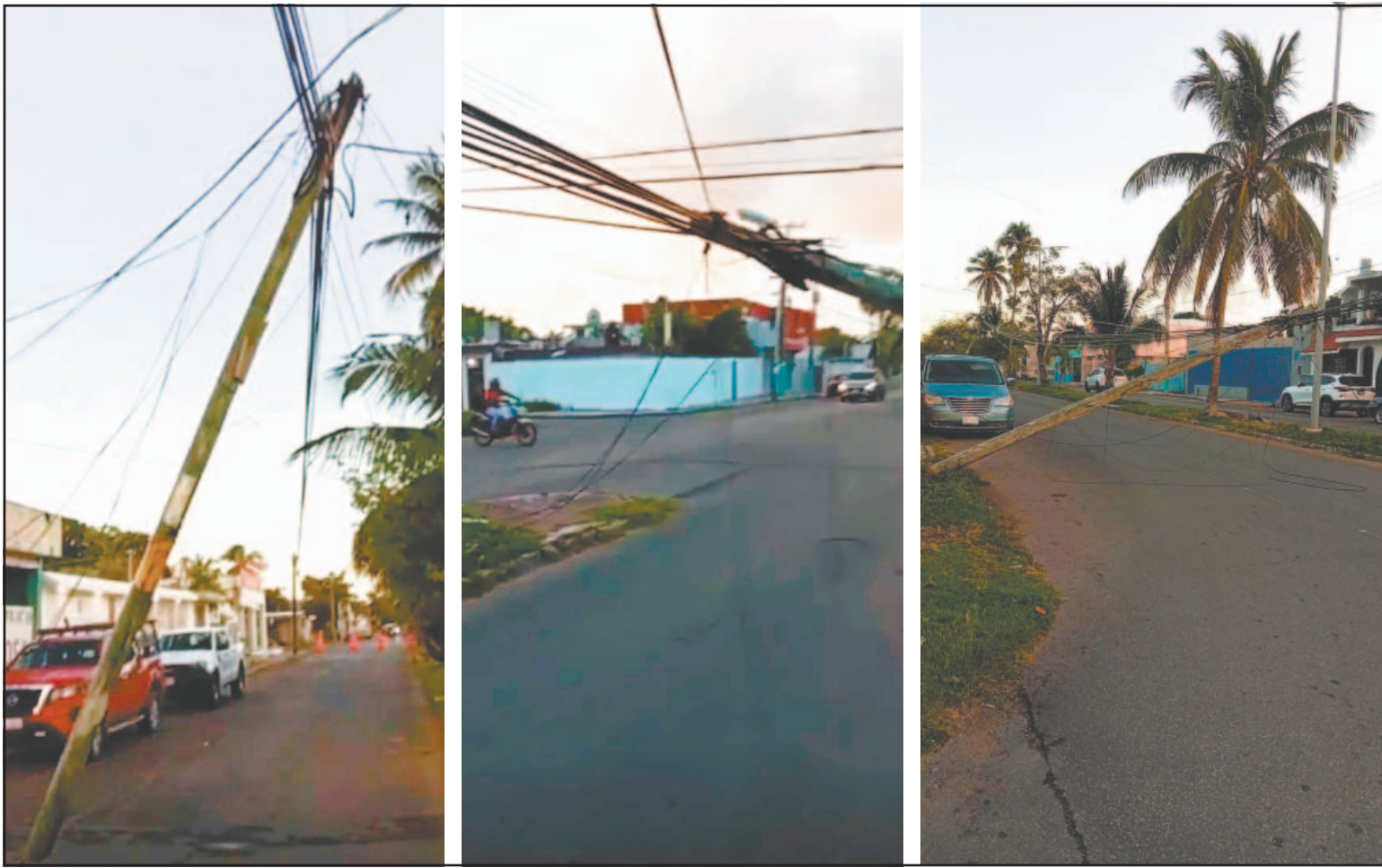
Preocupó a afectados que cables quedaran en el suelo con el riesgo de que se registrara un accidente; el conductor huyó del sitio. (F. Baeza)
