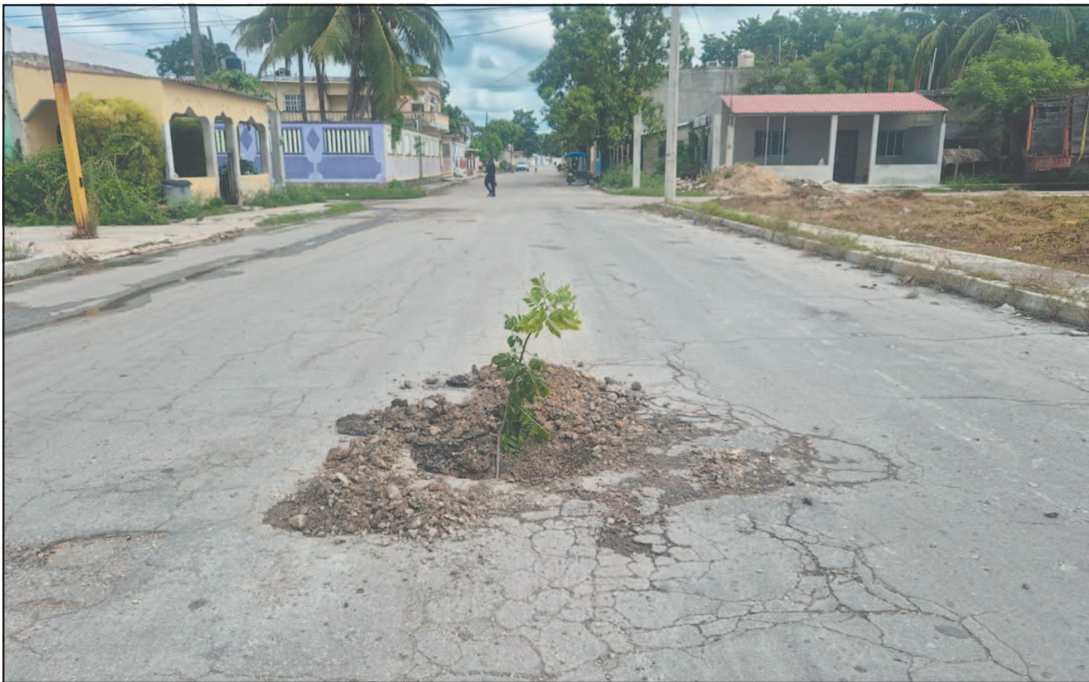
Exigen que el Smapach realice las reparaciones necesarias con material de calidad para evitar que la situación se repita. (Jorge May)
