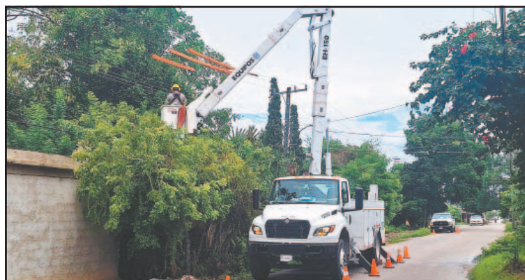
Fuertes vientos derribaron un árbol que cayó sobre los cables. (J. Xiu)
