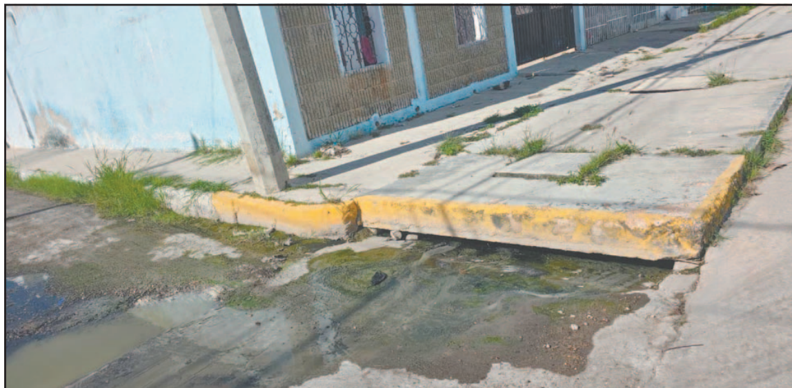
Habitantes señalan deficiencias en la infraestructura encargada de desalojar las aguas pluviales.
