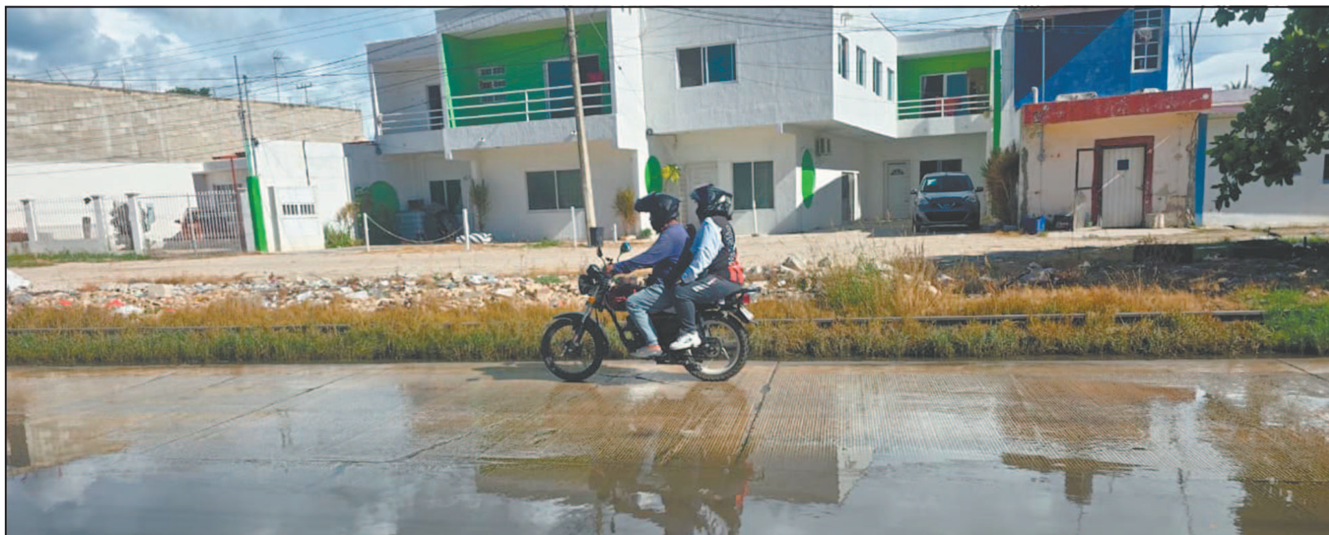
Alcantarillas en malas condiciones representan un riesgo para quienes caminan por la zona. Familias denuncian que las labores de desazolve prometidas no han sido concluidas.
