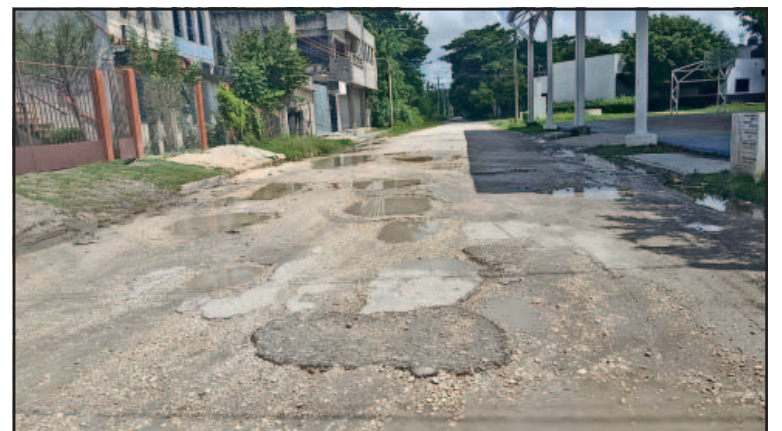
Los hoyancos afectan a varios sectores de la ciudad. (POR ESTO!)
