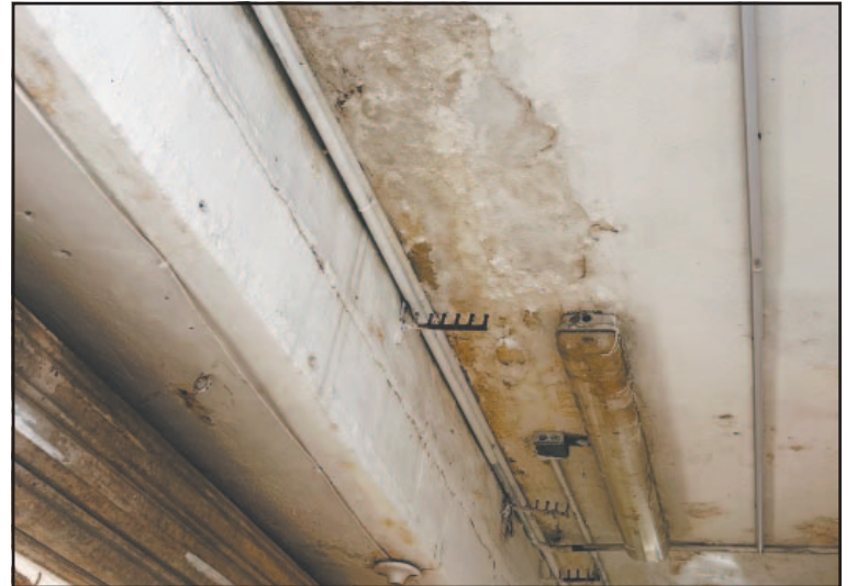
Denunciaron filtraciones en los techos cada que llueve. (E. Martín)
