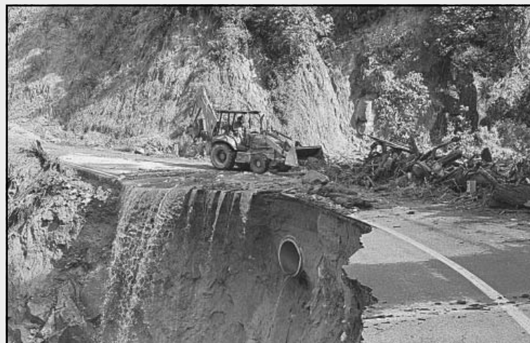
Elementos de Protección Civil atienden las primeras afectaciones.
