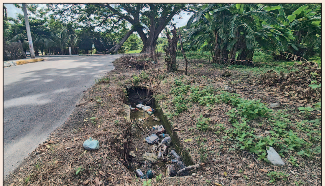
Desde que fue construido nunca pudo funcionar por fallas en la nivelación para que fluya el agua.
