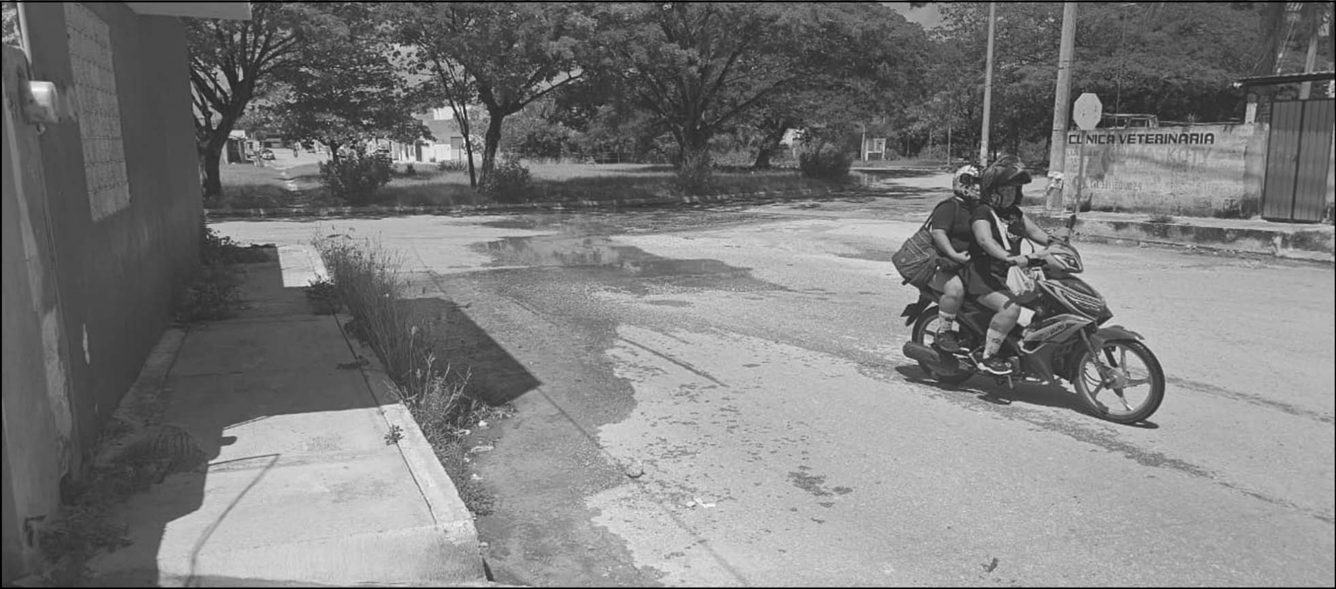
Los vecinos atribuyen el problema al presunto mal funcionamiento de la planta tratadora. Las principales afectaciones se concentran sobre la avenida Siglo XXI. (A. Pech)
