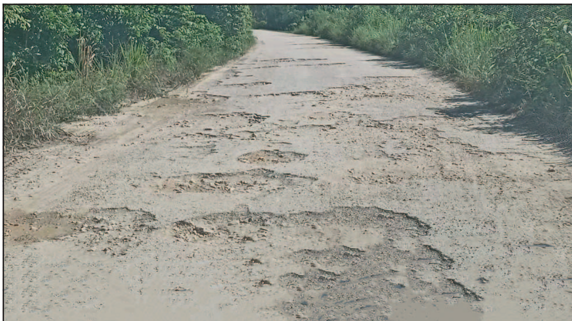
Algunos conductores enviaron fotografías para evidenciar el mal estado de los tramos estatales.
