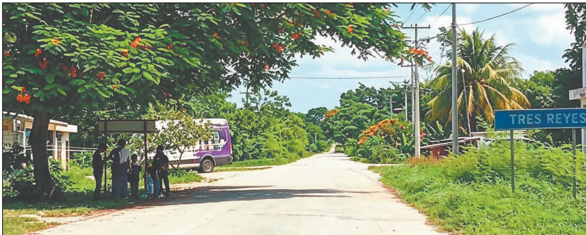
La carretera registra hundimientos, desniveles y pronunciadas deformaciones, además de carecer de mantenimiento en los acotamientos, situación que dificulta la circulación cotidiana.
