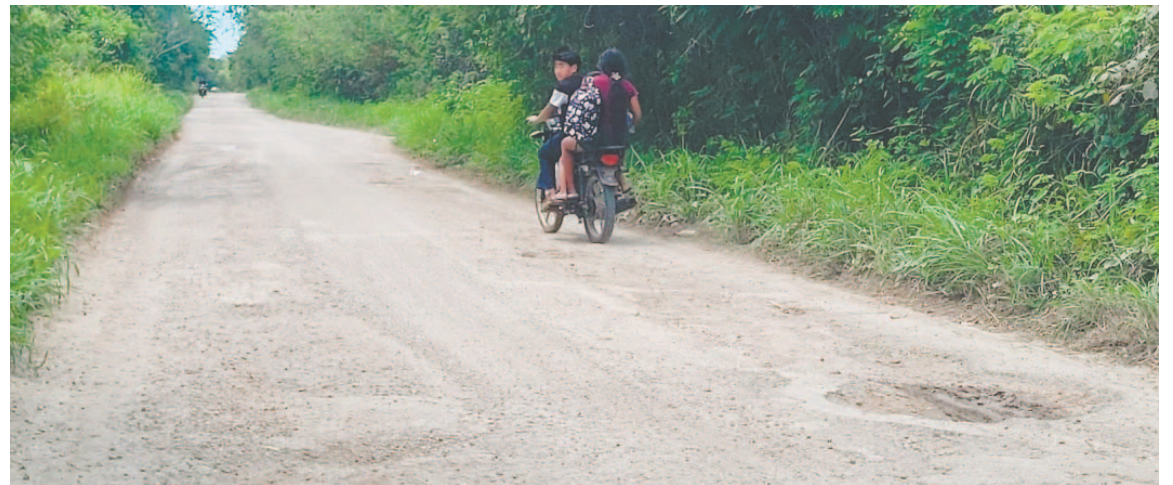
A diario, pobladores de Carrillo Puerto exponen su integridad al circular por caminos en mal estado.
